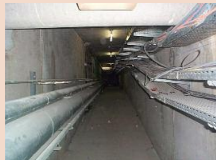
Galerie de câble
